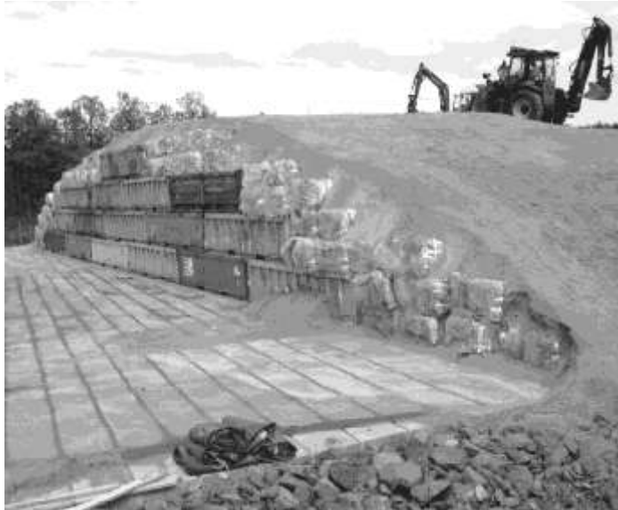
Figure A.1.3 : Installation de stockage pour les déchets de très faible activité à la centrale d'Oskarsham (Suède)
